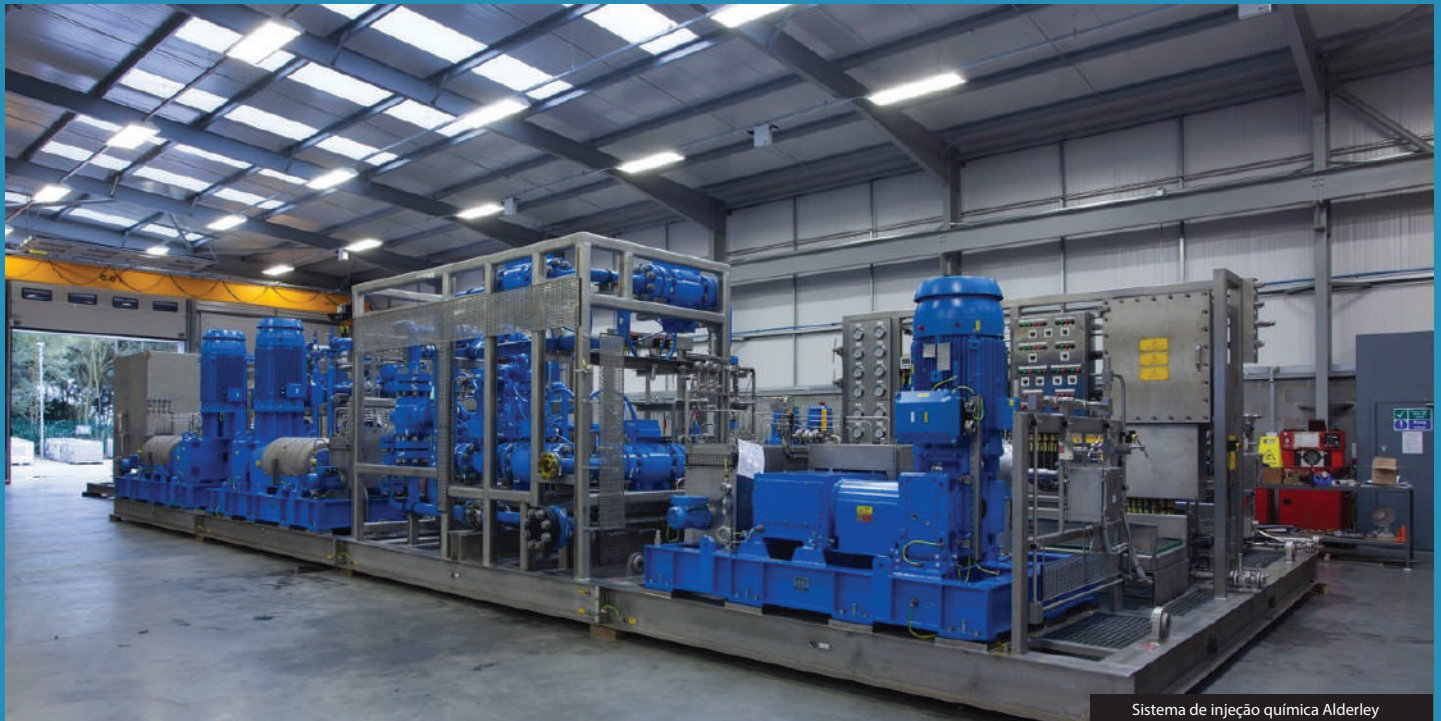
Sistema de injeção química Alderley
