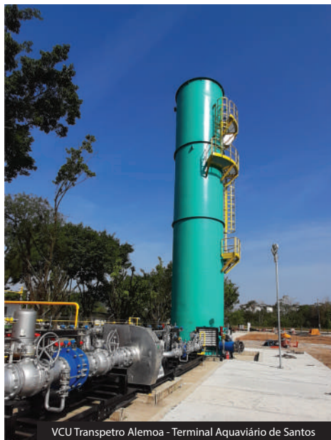
VCU Transpetro Alemoa - Terminal Aquaviário de Santos
