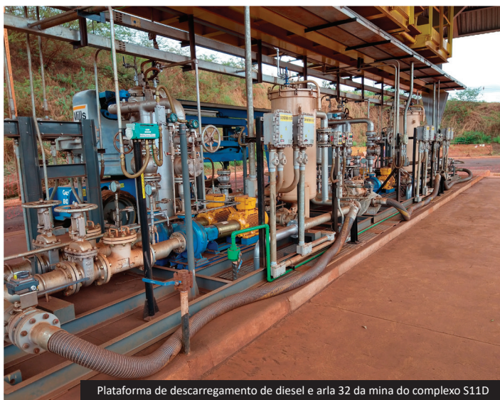
Plataforma de descarregamento de diesel e arla 32 da mina do complexo S11D
