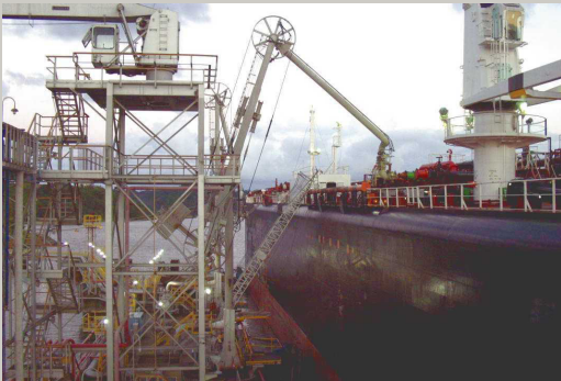
Braços de carga em operação no terminal da Braskem
