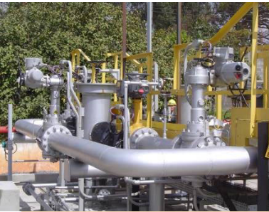
Instalações DTCS em São Caetano
